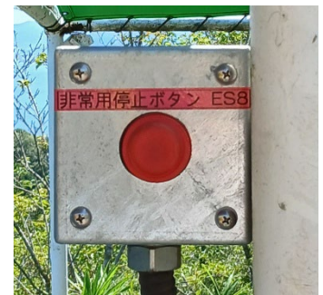
非常停止ボタン
