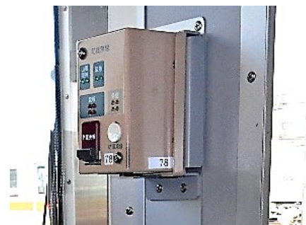
防護無線装置
