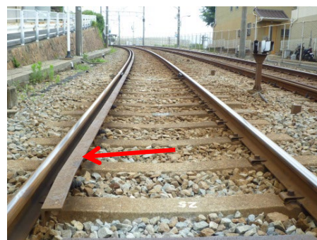
東垂水駅付近の脱線防止ガード
