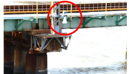
橋りょうに設置している水位計
