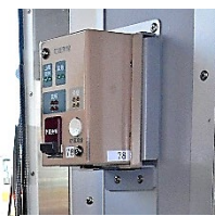
防護無線装置
