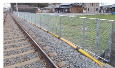
的形駅—八家駅間の立入防止柵
