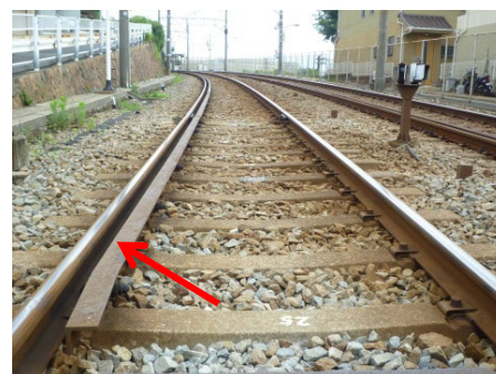
東垂水駅付近の脱線防止ガード
