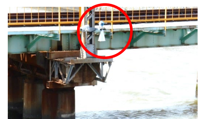
橋りょうに設置している水位計
