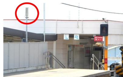
駅に設置している雨量計
