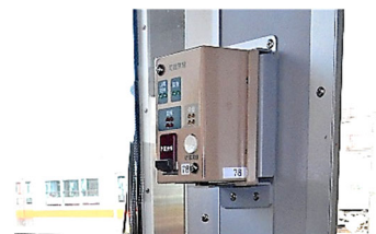
防護無線装置
