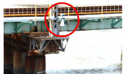
橋りょうに設置している水位計
