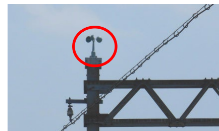
橋りょう上に設置している風速計
