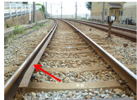
東垂水駅付近の脱線防止ガード
