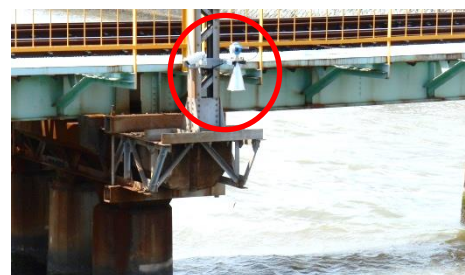
橋りょうに設置した水位計
