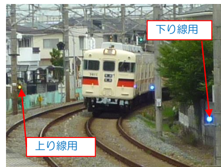
曾根駅付近の列車接近警報装置
