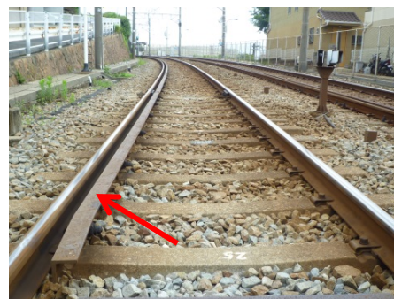
東垂水駅付近の脱線防止ガード
