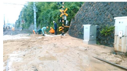
塩屋駅東方土砂流入
