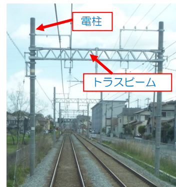
更新された浜の宮駅～尾上の松駅間の支持物
