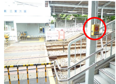
渡線道に設置している非常通報ボタン
