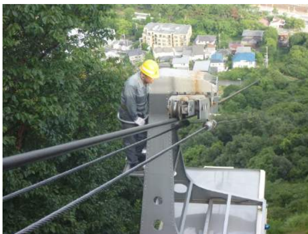
ロープウェイ走行輪の点検状況
