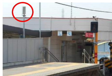
妻鹿駅に設置した雨量計
