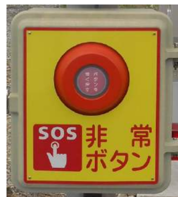
踏切非常通報ボタン
