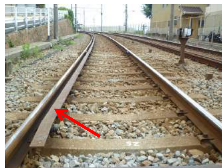
東垂水駅付近の脱線防止ガード
