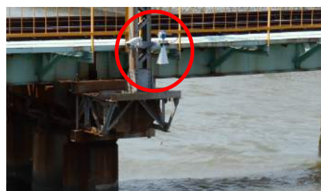
洗川橋梁に設置した水位計
