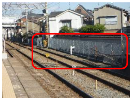
月見山駅東方の立入防止柵
