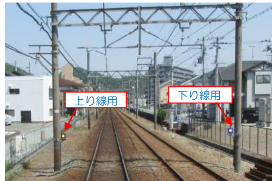
岩鼻踏切道付近の列車接近警報装置
