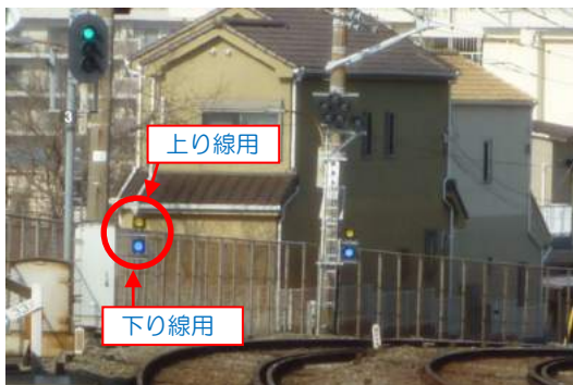
東垂水駅付近の列車接近警報装置
