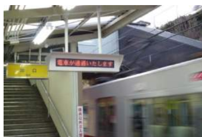
東垂水駅下りホームの列車接近案内装置
