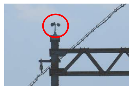
洗川橋梁風速計
