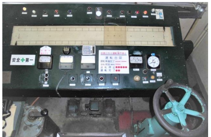
現在の手動式制御装置(ロープウェイ運転装置)
